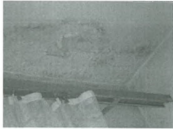
2-р зураг №14 тоот гал тогоо мөөгөнцөртсөн нь
